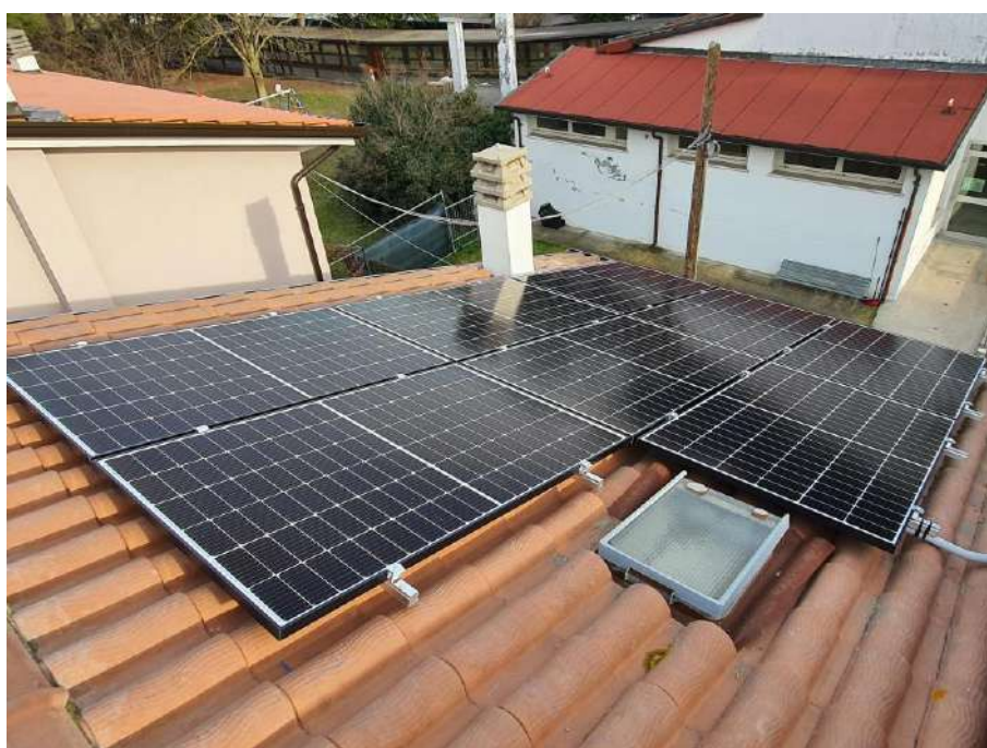
Figura 5 - Pannelli fotovoltaici in copertura
